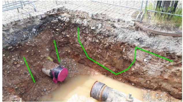
Obr. 9 – Prokořenění ve více provzdušněných vrstvách a zásypu plynovodu
